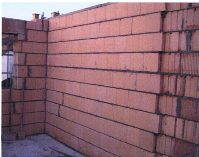
Abb. 6: zeigt ein nur durch eine aufgelegte Bohle schlecht geschütztes Mauerwerk (Bild: © Josef Reis)
