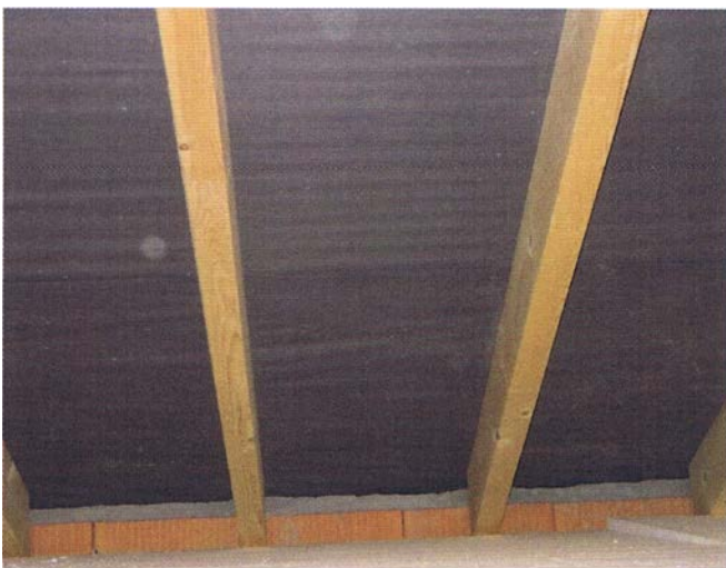
Abb.3: Schimmel auf Unterspannbahn (Bild: © Josef Reis)
