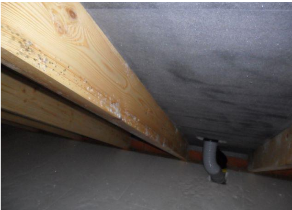
Schimmelpilze auf gehobelten Holzbalken.
