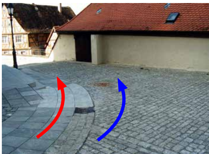
Abb. 6: Kirchentreppe mit altem (rot) und neuem (blau) Wasserverlauf auf der Oberfläche und im Pflasterbett. Mit Blick auf die Rückseite des Gebäudes des Antragstellers
