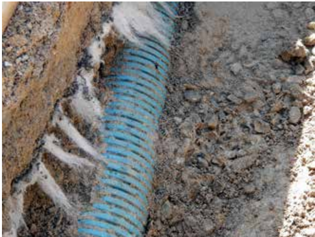
Abb. 10: Das blaue Drainagerohr hat keine Funktion, weil es mit Beton ummantelt wurde.
