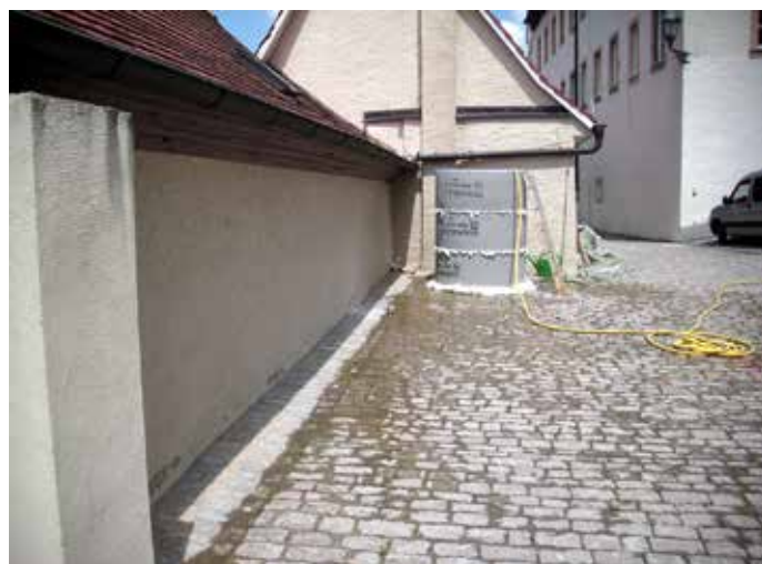
Abb. 7: Verschiedene Versuche wurden unternommen, um der Nässe nach Regenfällen auf die Spur zu kommen, auch mit Färbemittel Uranin.
