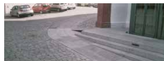
Abb. 5: Die erneuerte Kirchentreppe welche den Wasserabfluss verändert.
