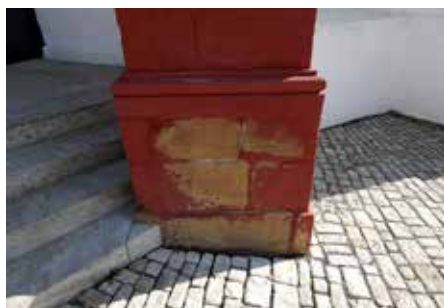
Abb. 12: Auch das Kirchportal steht mit seinen Füßen im eingeschlossenen und aufgestauten Wasser, auch wenn diese Feuchtigkeitsschäden noch niemandem aufgefallen sind oder in diesen Zusammenhang gebracht wurden.
