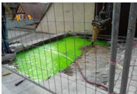
Abb. 11: Dieses Bild zeigt: Bei funktionsloser Drainage und von den Abdichtungsmaßnahmen eingeschlossen, gibt es für das Wasser keinen anderen Weg, als über die zu niedrige Wandabdichtung in das Mauerwerk des Gasthauses einzudringen.
