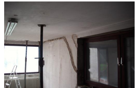
(3) Übersichtsbild des Wohnzimmers der Souterrainwohnung mit Rissen in Decke und Außenwand (Bild: © Josef Reis) (zweispaltig)
