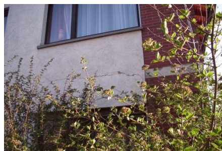
(2) Abriss zwischen Decke und aufsteigender Wand (Bild: © Josef Reis)
