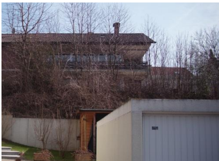
(1) Neu bebauter Hang unterhalb des Gebäudes (Bild: © Josef Reis)
