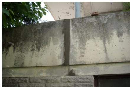
(11) Geschlossener Riss an der Betonbrüstung (Bild: © Josef Reis)
