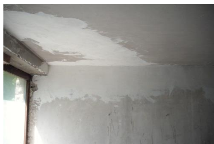
(12) Gespachtelter und geschliffener Deckenriss (Bild: © Josef Reis)
