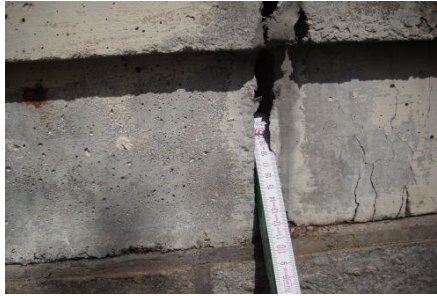
(8) Riss in der Betonbrüstung des Balkons; die Rissbreite des Risses beträgt 2,5 – 3 cm. Man hatte bereits versucht, den Riss mit Silikon zu schließen. (Bild: © Josef Reis) (zweispaltig, falls möglich)
