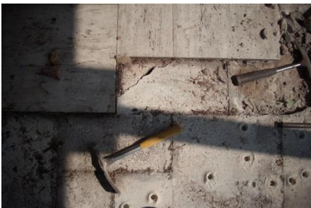
(7) Der Deckenriss von Abb. 5 ist unter dem Natursteinbelag des Balkons sichtbar. (Bild: © Josef Reis)
