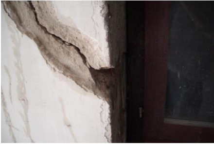
(5) Ausgebrochener Beton an einem Wandriß (Bild: © Josef Reis)
