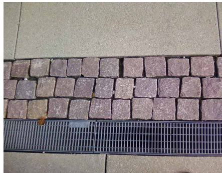
Abb. 5: Loses Pflaster durch Absaugen des Verfügungsmaterials durch die Reinigungsmaschine bei breiten Fugen
