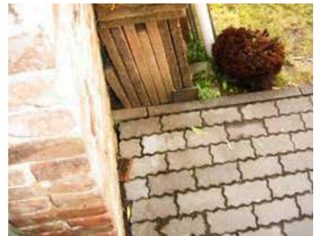
Abb. 6: Falscher Pflasteranschluss an die Hauswand
