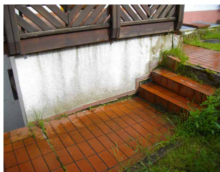
Abb. 11: Fehlende Dehnungsfuge zwischen Betonplatte und Wand
