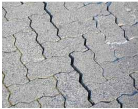
Abb. 2: Loser, beschädigter Pflasterbelag mit offenen Fugen
