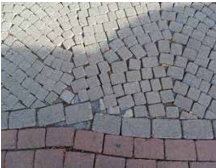
Abb. 4: Verschobenes Pflaster durch Beschleunigung und Abbremsung wegen fehlendem Verbund bei ungebundener Bauweise
