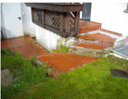
Abb. 10: Absenkungen des betonierten und mit Platten belegten Gartenwegs wegen ungenügender Verdichtung und der Verfüllung von Bauabfällen (Folien, Eimer, Bauschutt)
