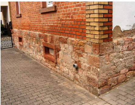
Abb. 7: Nasse Hauswand als Folge eines Pflasterwandanschlusses ohne Wandabdichtung
