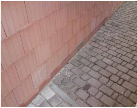
Abb. 1: »Ökopflaster« mit 1,5 cm breiten Fugen und fehlender Wandabdichtung auf Splittbett, ohne Drainage
