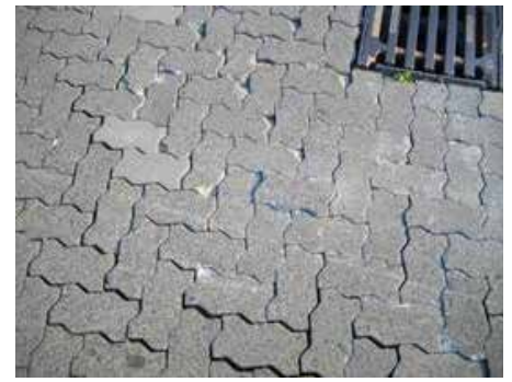
Abb. 3: Hochstehende und beschädigte Pflastersteine bei Belag auf Beton, gebundene Bauweise
