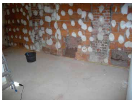
Abb. 2 zeigt die auch nach den Trocknungsmaßnahmen noch nasse Gebäudewand im Erdgeschoß zum Berg.
