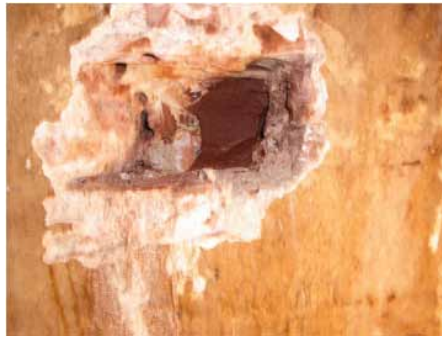
Abb. 5 zeigt eine Wandöffnung in der Kellerwand mit auslaufendem (Kanal)Wasser
