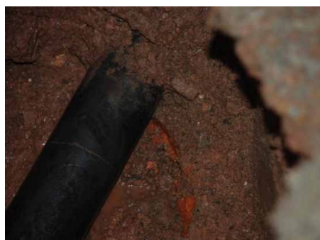
Abb. 1 zeigt das gebrochene und mit einer Manschette geflickte Wasserleitungsrohr.
