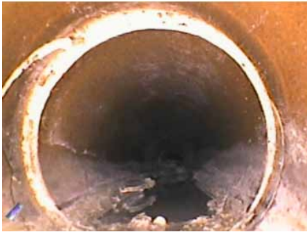
Abb. 7: Beispielhaft ein versetztes Kanalrohr mit Scherbenbildung an der Rohrspitze des einbindenden Ton Rohrs.
