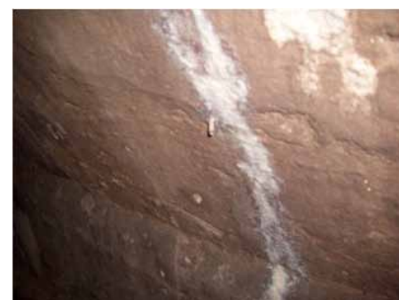
Abb. 3 zeigt die betroffene Gewölbewand im Keller kurz nach dem Rohrbruch
