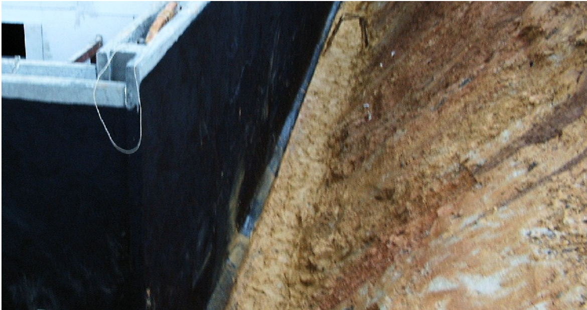
Bild 3. Mit Lehm verschmutzte (1. Lage) KMB-Abdichtung. Die hellen Stellen zeigen das Bewehrungsgewebe.
